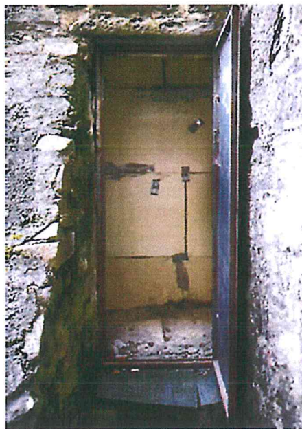
8 intercapedine retrostante la base della cappella dei Caduti a Cortona.
